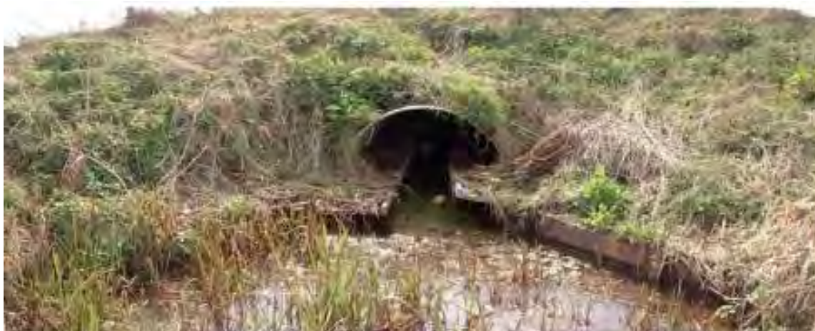
Afbeelding: Voorbeeld loopplank in duiker
