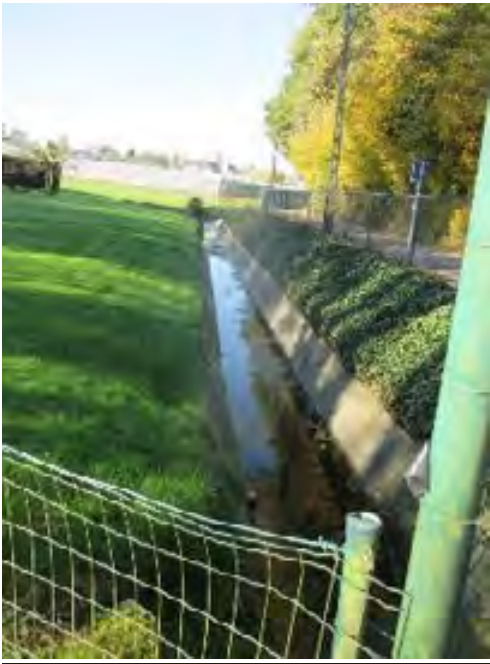
Foto: Nellebeek in betonnen kuip ter hoogte van Lindaal
