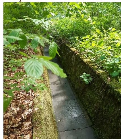
Figuur 5: Afwateringsgracht van de R0, uitgevoerd in betonnen cunette. Thv de Raafeikenweg in het Zoniënwoud.
