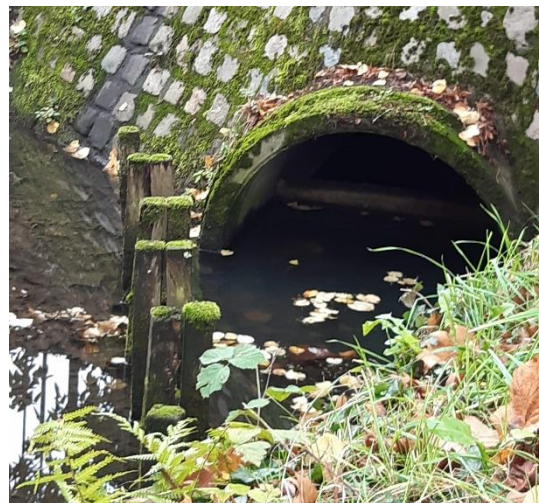
Figuur 3: Overstort met laag drempelpeil op de IJse in de J.B. Charlierlaan
